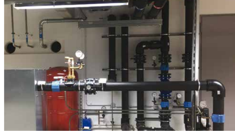
Wärmerückgewinnung aus dem Prozesswasser am Standort Rottenburg-Ergenzingen.
