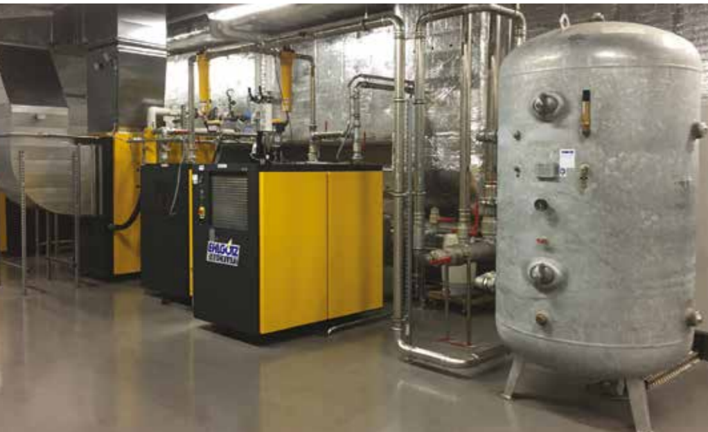
Moderne Druckluftanlage am Standort Nufringen.
